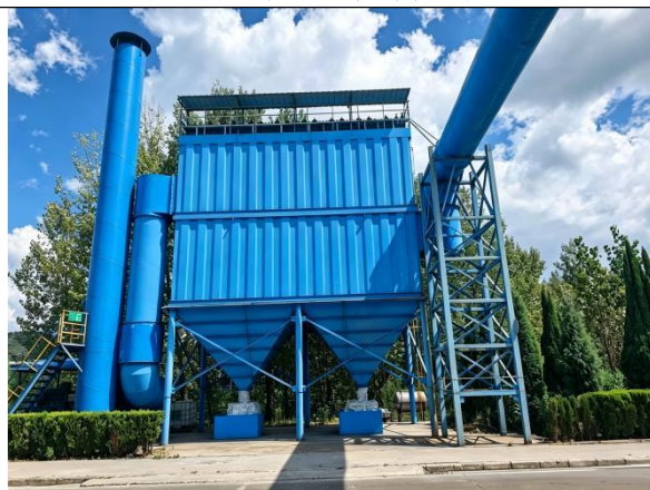
废气治理设施
